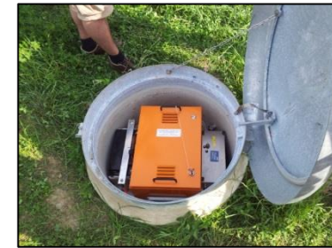
Réseau de surveillance sismique
