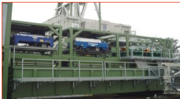
Traitement de la boue de forage et séparation des solides
