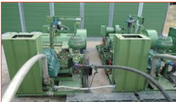
Pompes pour le circuit de boue de forage
